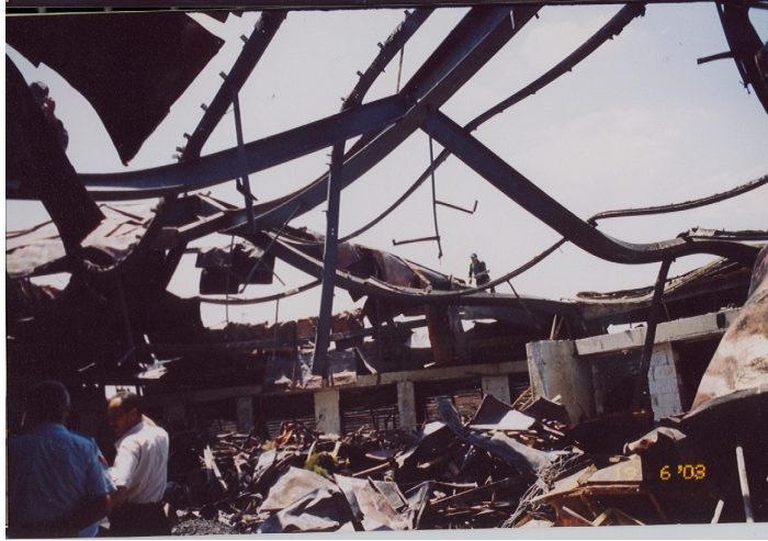
Resim 4.1. MNG Hizmet Binası 10. katının yangından sonraki hali
