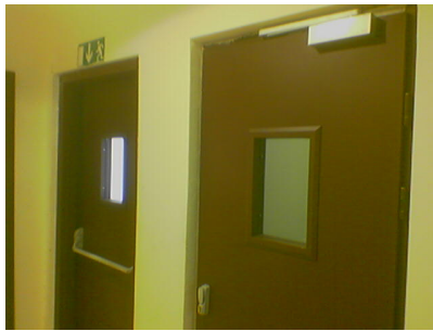
Resim 4.2. Zemin katta bulunan 90 dakika dayanımlı yangın kapıları
