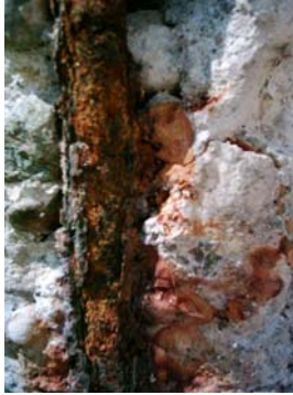
Resim 2.2. Betonarme çeliğinde korozyon
