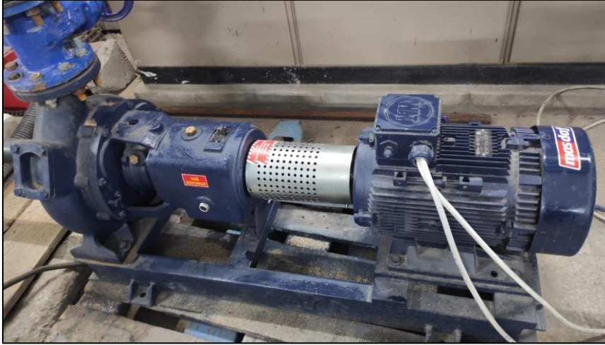
Şekil 3.3. Atık su pompası
