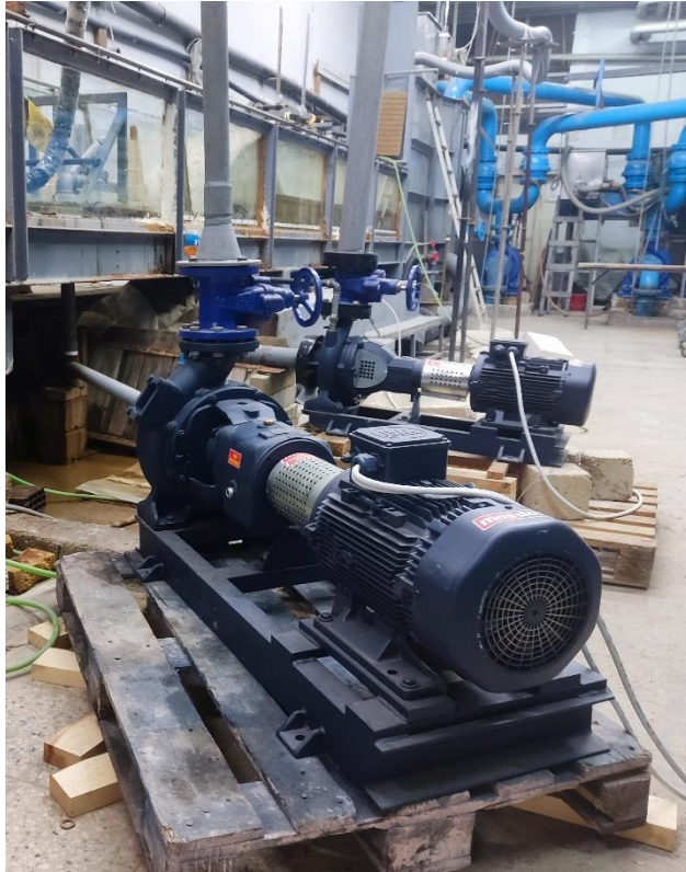
Resim 4.2. Atık su pompası
