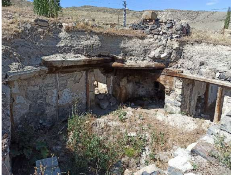
Resim 4.67. Yıkılmış kırlangıç kubbeli bir ev (Fotoğraf: Hasan Söylemez)
