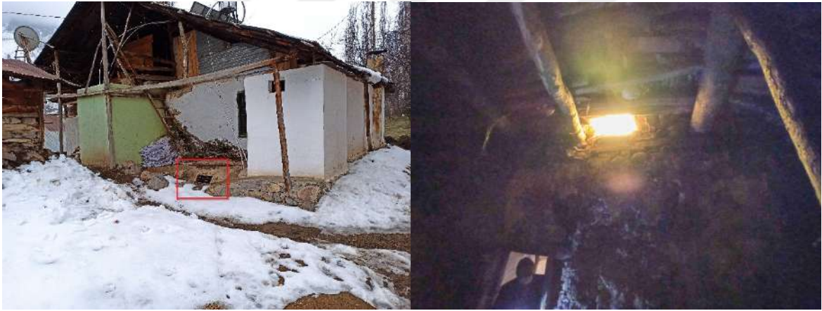
Resim 4.51. Arka cephede pasin örtüşü ile açılan pencere (Fotoğraf: Hasan Söylemez)
