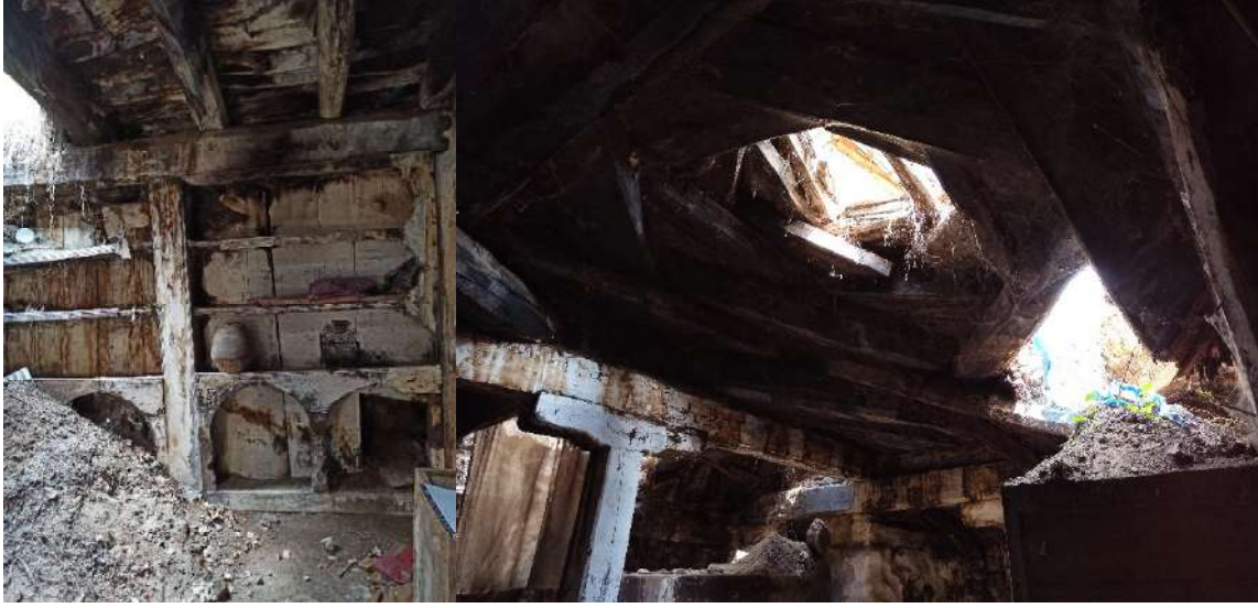
Resim 4.49. Mutfak nişi ve yıkılan kırangıç kubbe-Temmuz 2021 (Fotoğraf: Hasan Söylemez)
