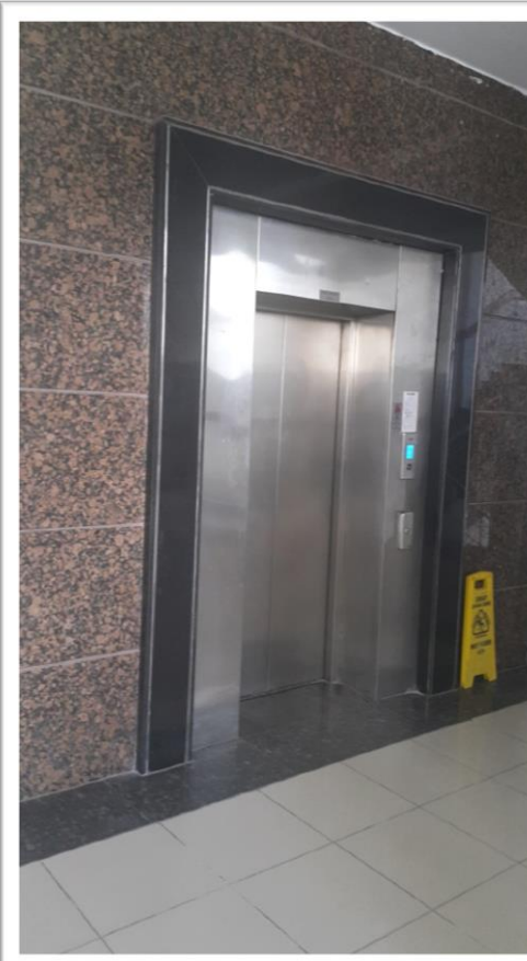
Şekil 59. F blok binası asansör
