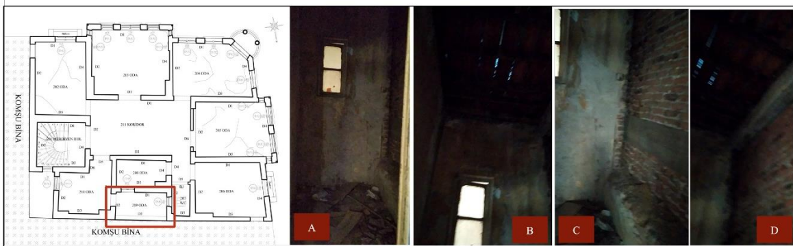
Resim 4.26. 209 nolu odaya ait görseller: (A)D4 duvarı, (B)D4 duvarı ve tavan döşeme, (C)D3 duvarı, (D)D3 duvarı ve kiriş
