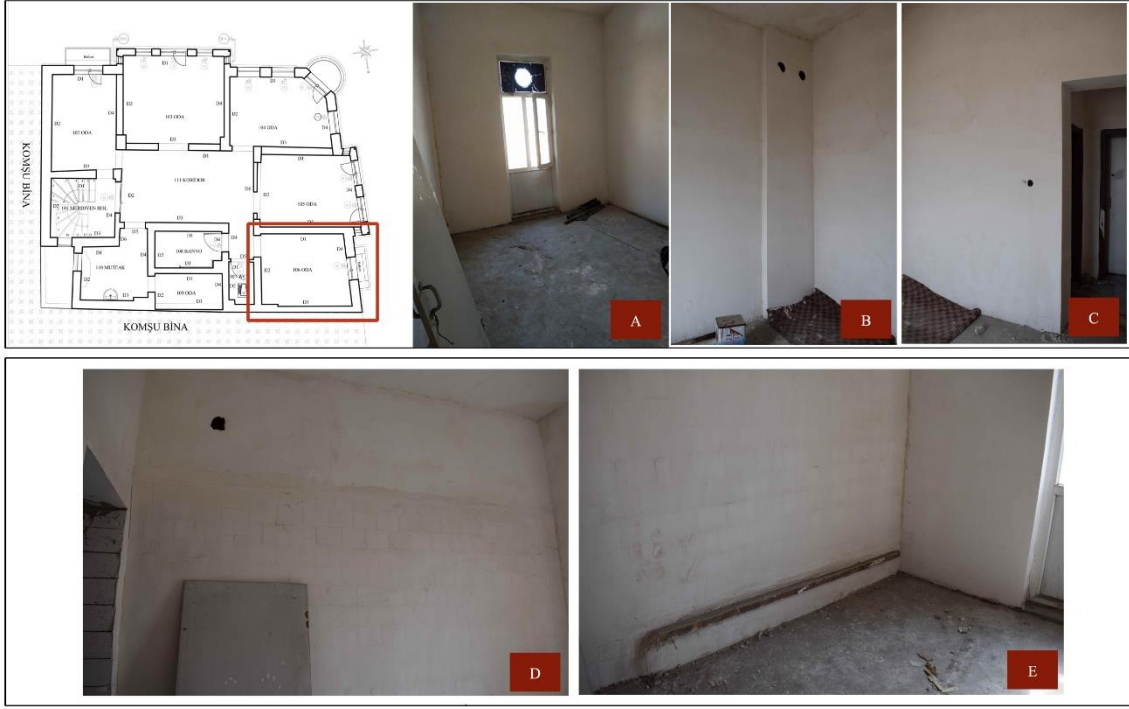
Resim 4.12. 106 nolu odaya ait görseller: (A)oda zemini ve D4 duvarındaki balkon penceresi/kapısı; (B)D3-D2 duvarı kesişimi; (C)D2 duvarı ve kapı açıklığı; (D),(E) D1 duvarı
