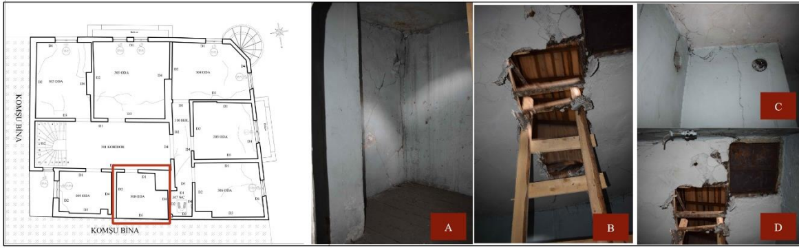
Resim 4.36. 308 nolu odaya ait görseller: (A)D4-D3 duvarı kesişimi, (B)Oda tavanı, (C)D1 duvarı ve baca kesişimi, (D)Oda tavanı, çatı çıkışı
