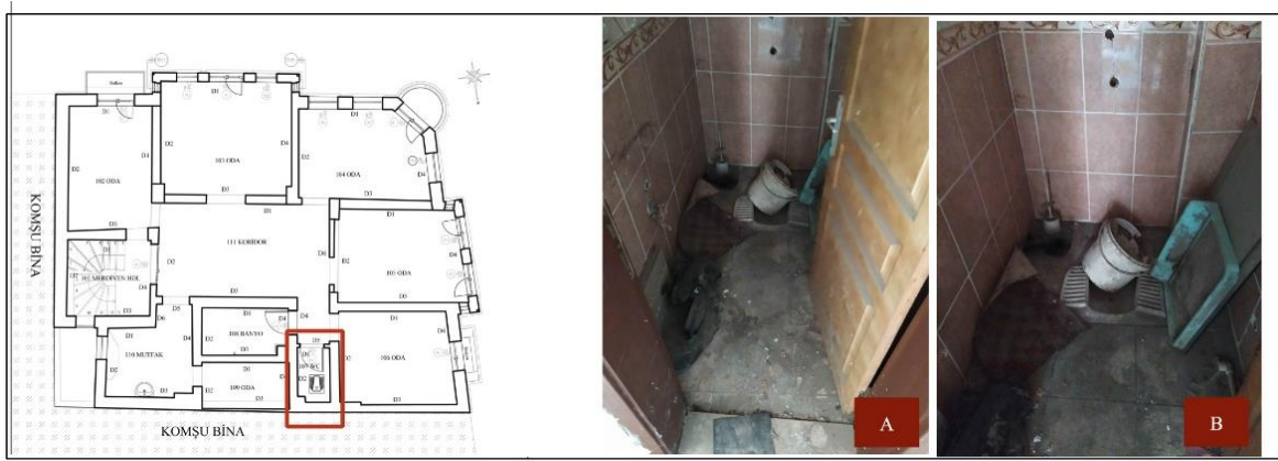
Resim 4.13. 107 nolu WC'ye ait görseller: (A)Giriş kapısı ve zemin, (B) mahal zeminini
