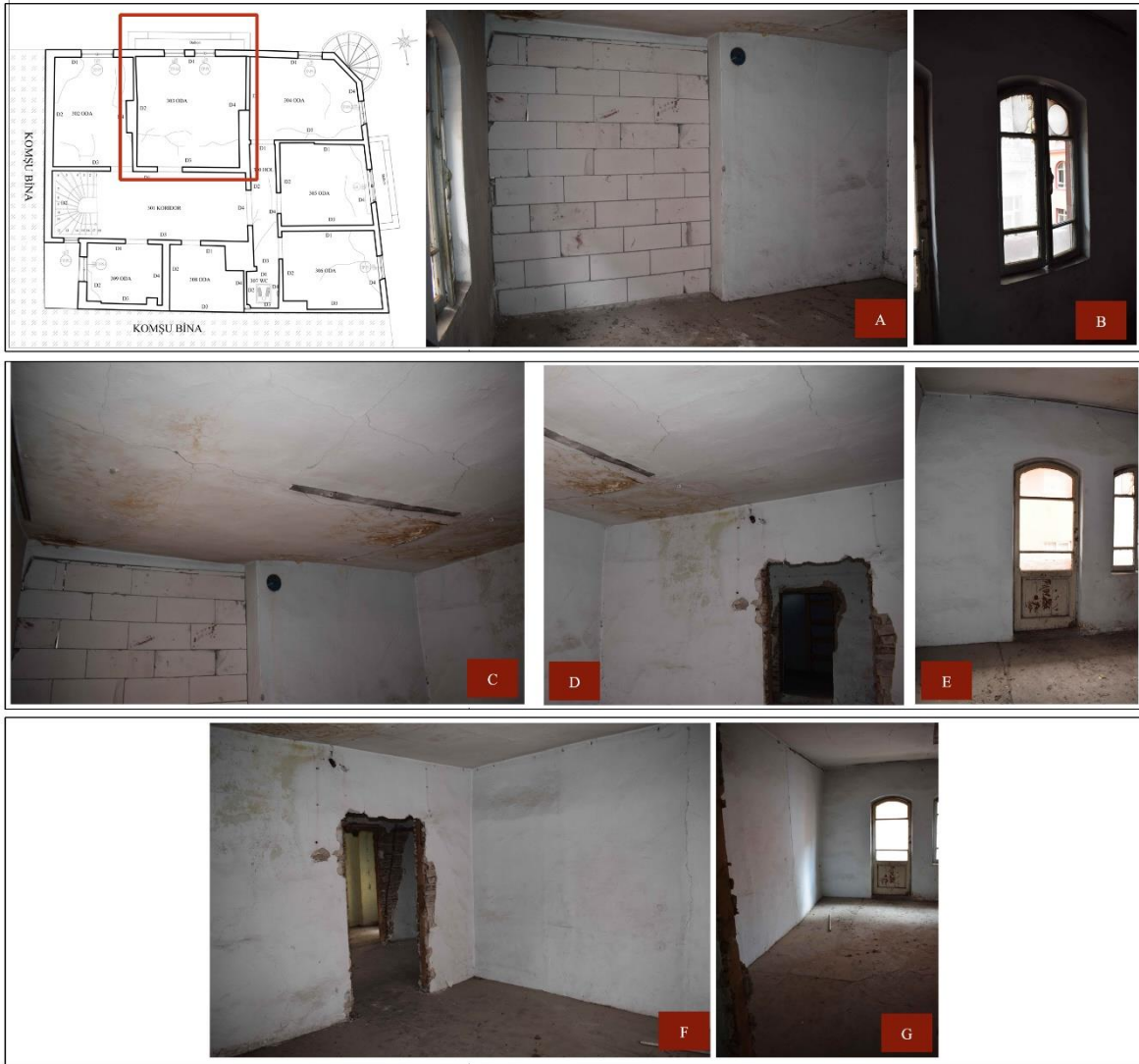
Resim 4.31. 303 nolu odaya ait görseller: (A)D4 duvarı, (B)D1 duvarı ve pencere, (C)D4 duvarı ve tavan, (D)D3 duvarı ve tavan, (E)D1 duvarı ve balkon kapısı, (F)D2-D3 duvarı kesişim ve mahale giriş kapısı açıklığı, (G)D2 duvarı görünümü
