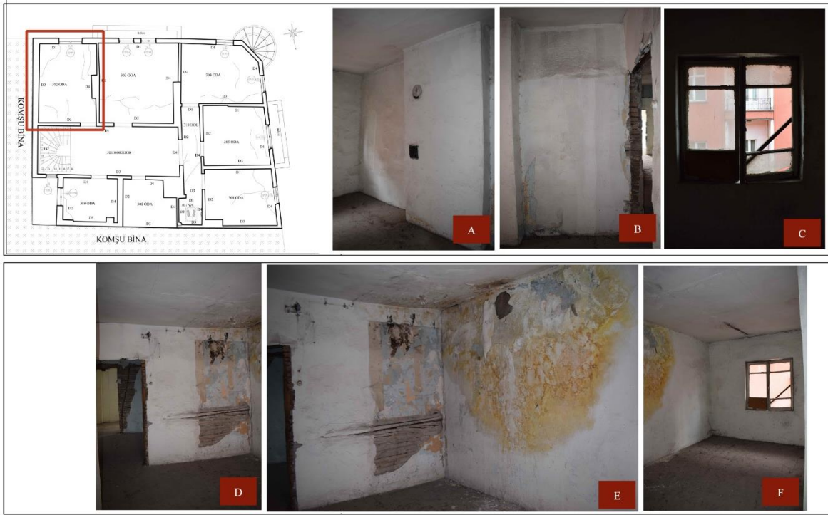
Resim 4.30. 302 nolu odaya ait görseller: (A)D4 duvarı, (B)D4 duvarı, (C)D1 duvarı pencere, (D)D3 duvarı, (E)D3-D2 duvarı kesişimi, (F)iç mekan görünümü
