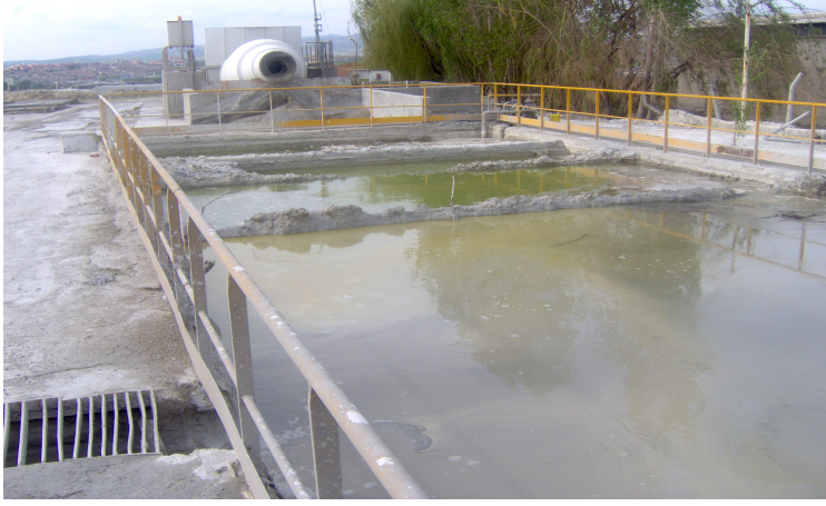
Resim 3.5. Hazır beton santrali çökeltme havuzu
