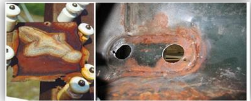
Farklı görünümelerde aralık korozyonu
