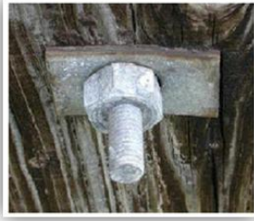
Farklı metallerin oluşturduğu galvanik korozyon
