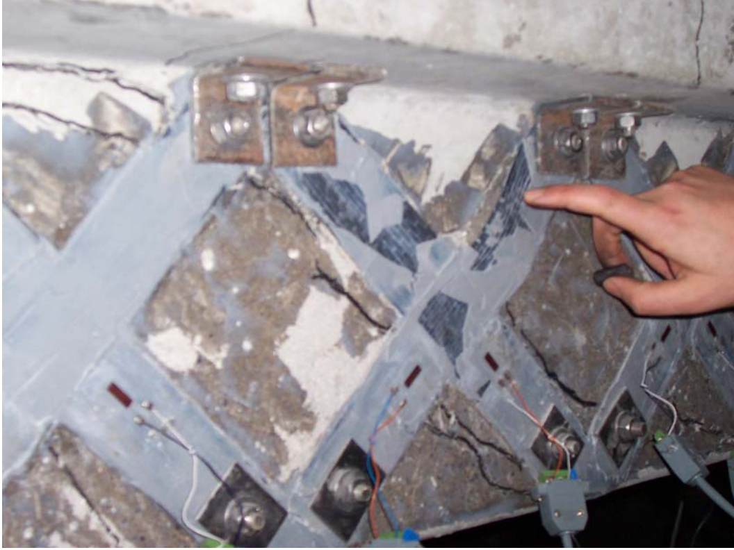
Resim 4.3. Yapışma yüzeyinden ayrılan CFRP şerit
