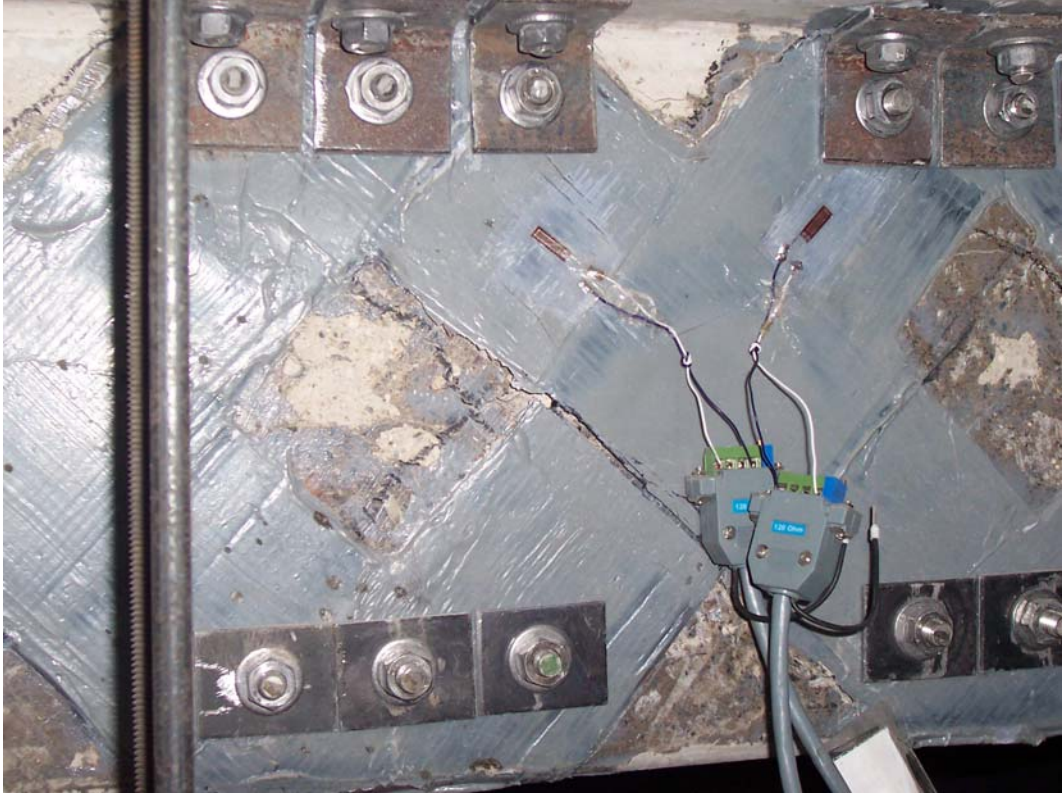
Resim 4.6. Kesme çatlağı ve kesme çatlağından dolayı kopan CFRP şerit
