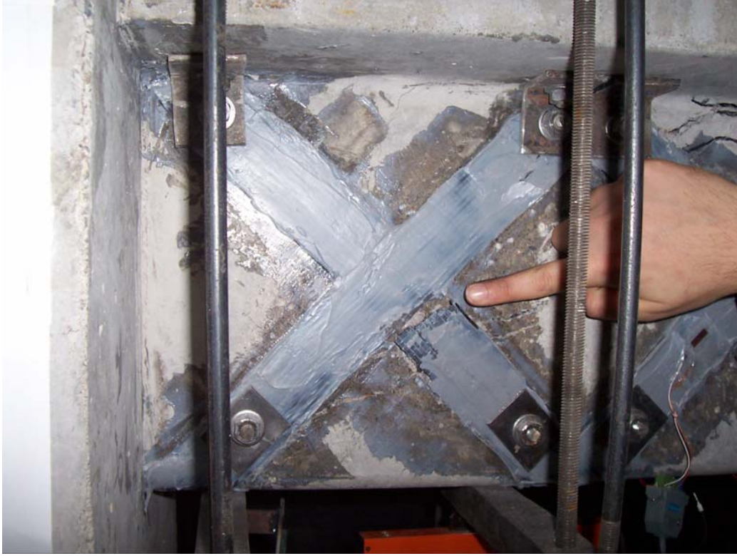
Resim 4.4. Kesme çatlağı nedeniyle kopan CFRP şerit
