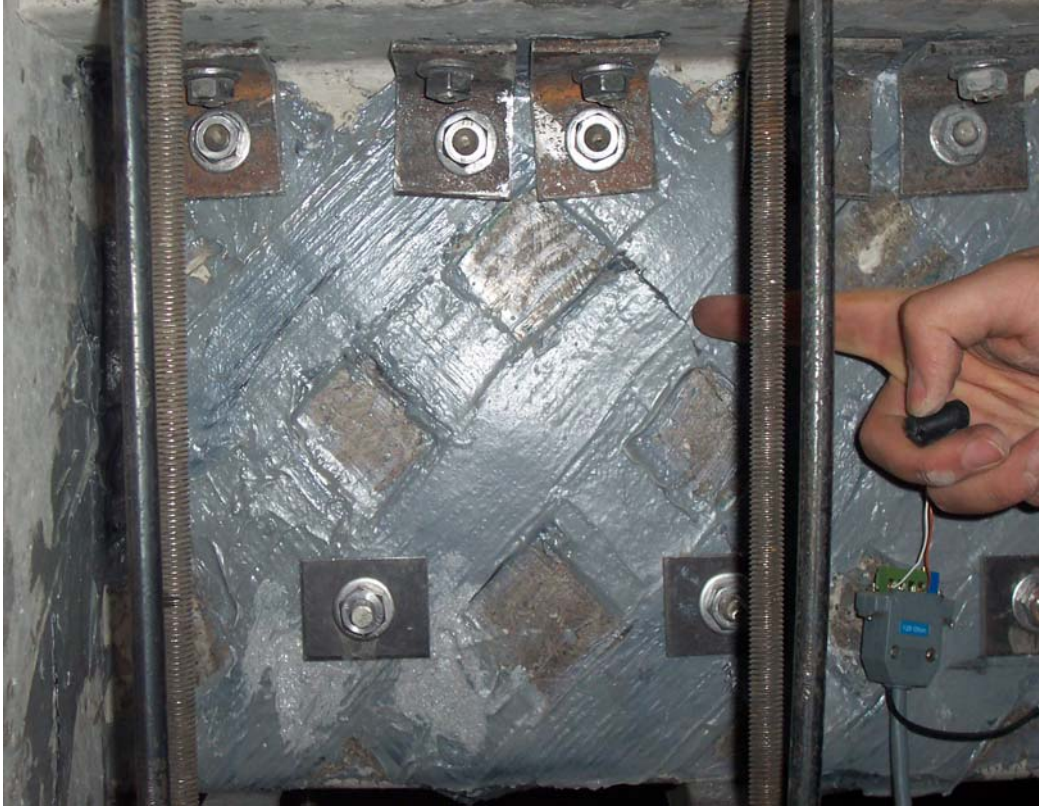
Resim 4.8. Kesme çatlağı ve kesme çatlağından dolayı kopan CFRP şerit
