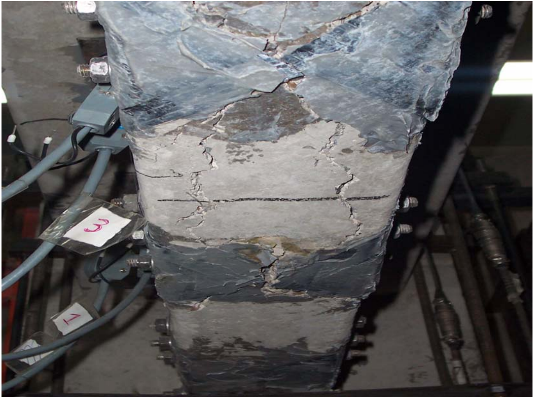
Resim 4.7. Kesme çatlağının kiriş altında oluşturduğu boyuna çatlaklar
