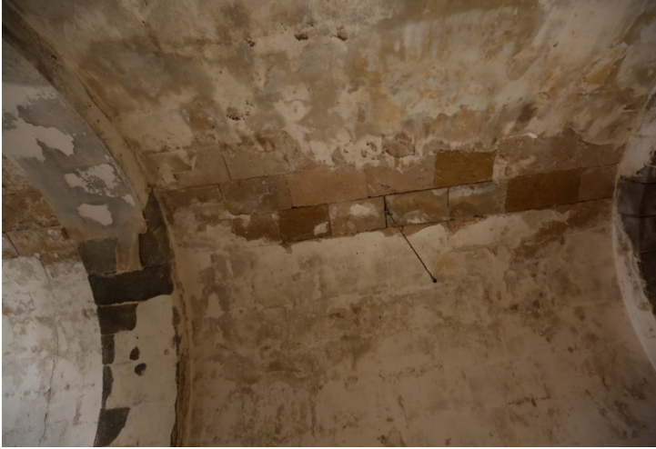
Resim 5.78. Taş üzeri nemlenme ve sıva dökülmesi
