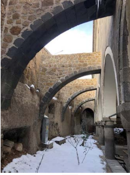
Resim 6.107. Aşağı Kayabaşı Kilisesi'nin avlu duvarını tutan payandalar
