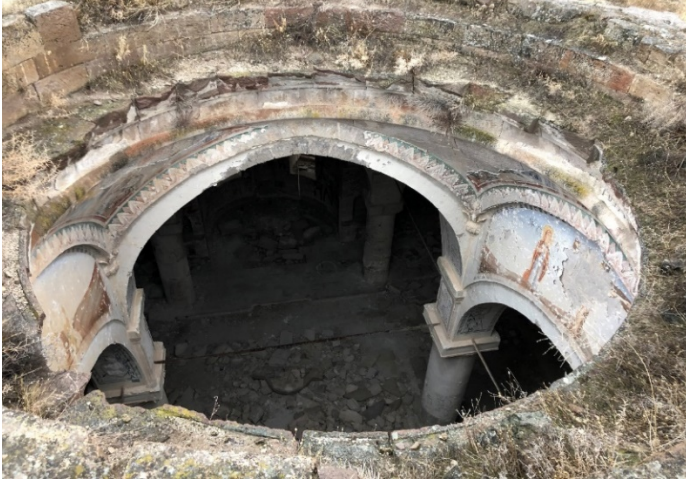
Resim 6.62. Yanartaş Kilisesi'nin yıkılan kubbenin çatı üzerinden görünümü
