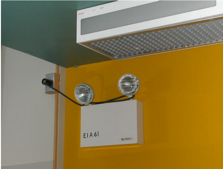
Resim 5.2. Jeneratörlerin beslediği acil aydınlatma elemanları [81]
