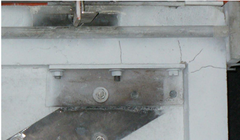
Resim 4.3. Kolon-kiriş birleşiminde çatlak.
