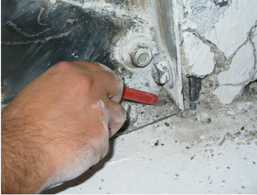
Resim 4.26. 16. çevrim sonunda sağ alt köşe yırtılma detayı
