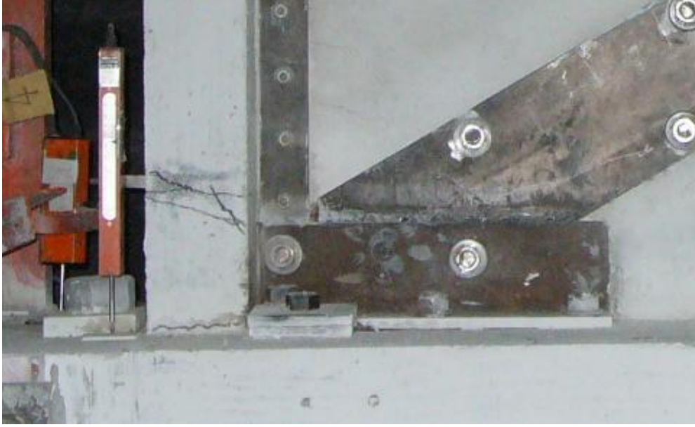
Resim 4.6. 19. yük çevrimi sonrası sol kolon bindirme bölgesi hasarı
