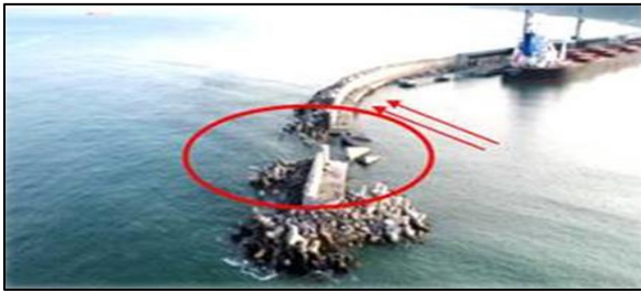
Şekil 5.2. Mendireğin hasardan sonraki durumu
