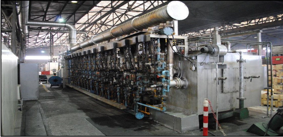
Resim 1.8. Sertleştirme fırını brülör ve baca tesisatı
