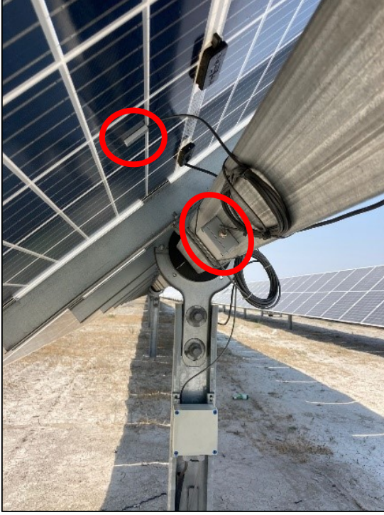
Şekil 4.9. Santral içerisinde montajlanmış bir FV modül sıcaklık sensörü
