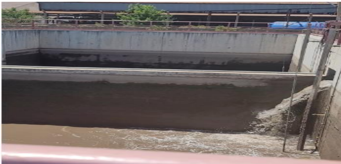
Resim 3.11. Dengeleme havuzu fotoğrafı
