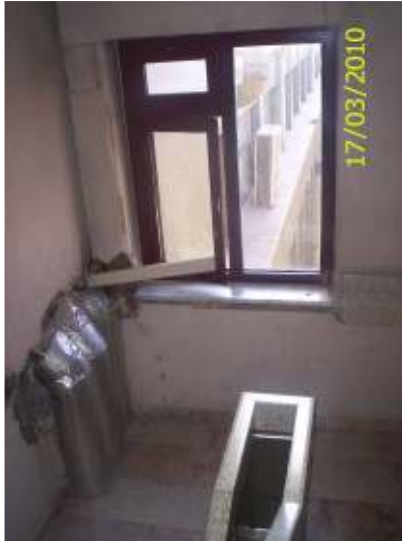
Resim 4.10. D1 blok kaçış merdiveninde tesisat kanalları açıkta
