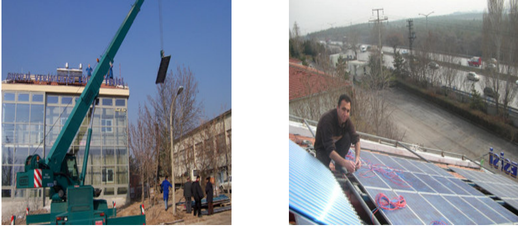
Resim 4.9. Şebeke bağlantılı 5,08 kWp güneş pili sistemi [44]
