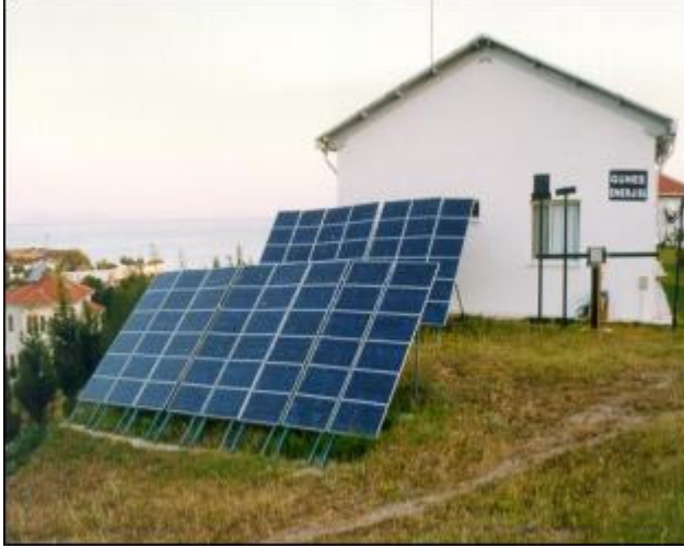
Resim 4.8. Şebeke bağlantılı 4,8 kWp güneş pili sistemi [44]
