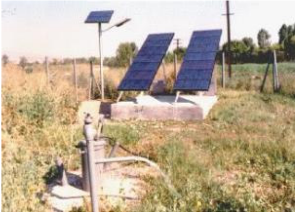
Resim 4.5. Güneş pili su pompaj sistemi [44]
