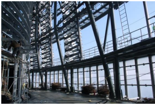
Resim 4.12. Kulenin bitiş parapetine yerleştirilen rüzgâr türbinleri [148]
