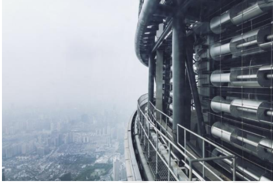
Resim 4.11. Kulenin bitiş parapetine yerleştirilen rüzgâr türbinleri [147]
