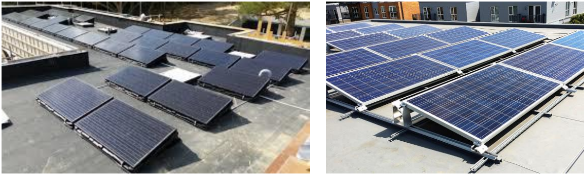
Şekil 3.1. Düz çatıya monte fotovoltaik paneller (www.solar.inventoturkiye.com)
