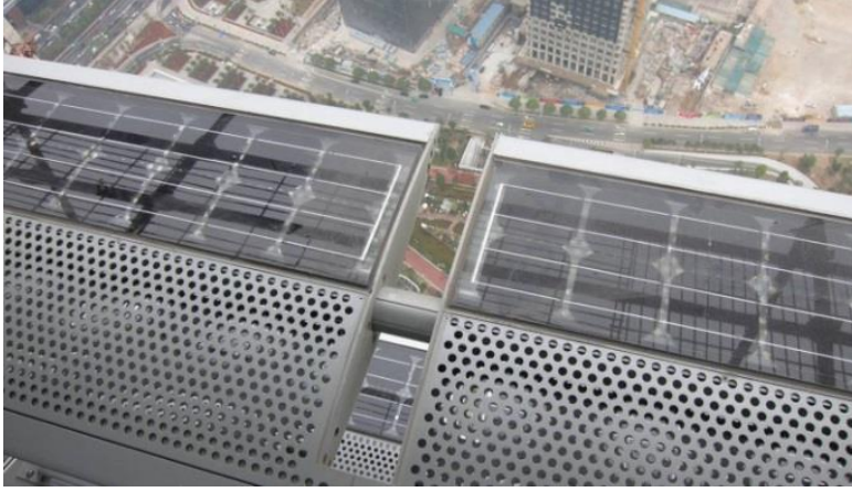
Şekil 5.8. Pearl River Tower cephesinde kullanılan sabit 0 derece güneş kırıcılar
