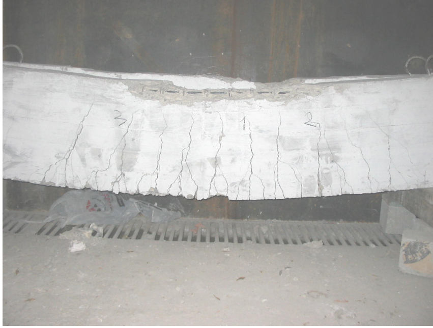
Resim 4.2. PSb3 elemanında görülen deformasyonlar
