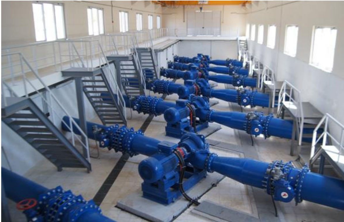
Resim 3.1. Terfi istasyonu ve pompalar (Tekirdağ/Çerkezköy terfi istasyonu)
