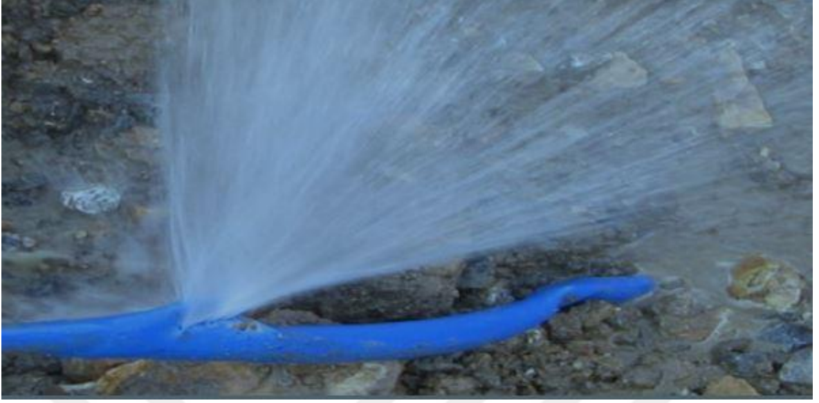
Resim 5.1. Düşük çaplı PE abone bağlantı borusuna ait arıza durumu
