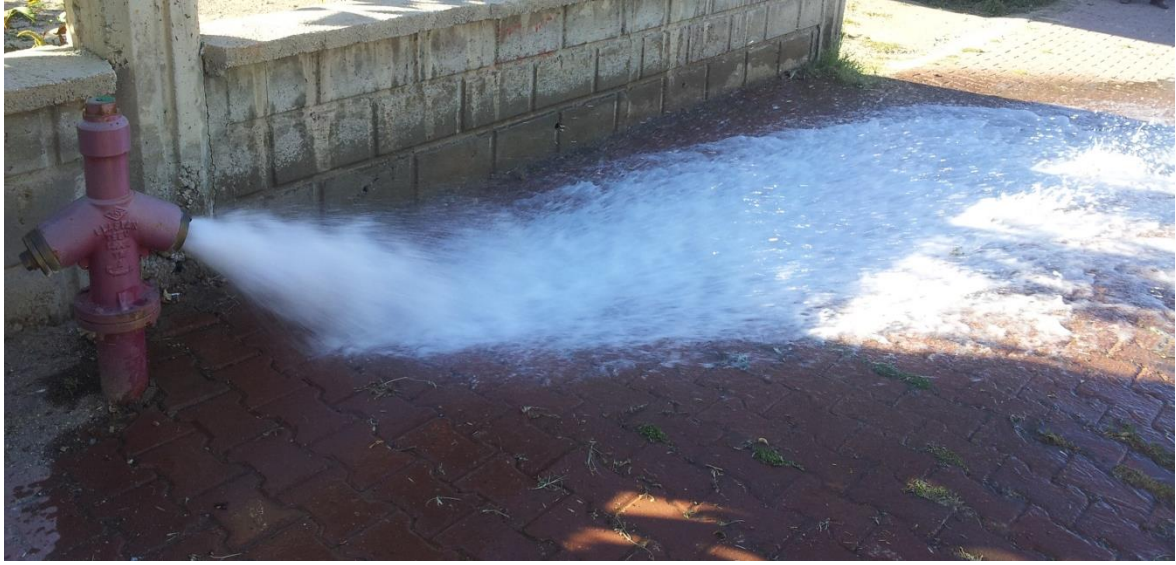
Resim 3.4. Yangın hidrantları (Yangın muslukları/Kayseri-Yahyalı)
