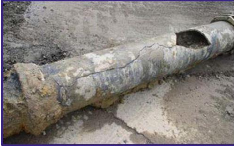
Resim 5.6. Su koçu darbesi sonucu asbest çimento boru [6]
