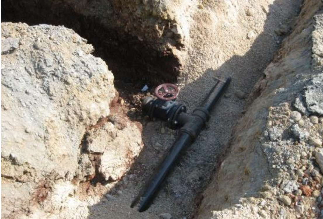
Resim 4.3. Pvc boru (Derinkuyu/Nevşehir mevcut hat)
