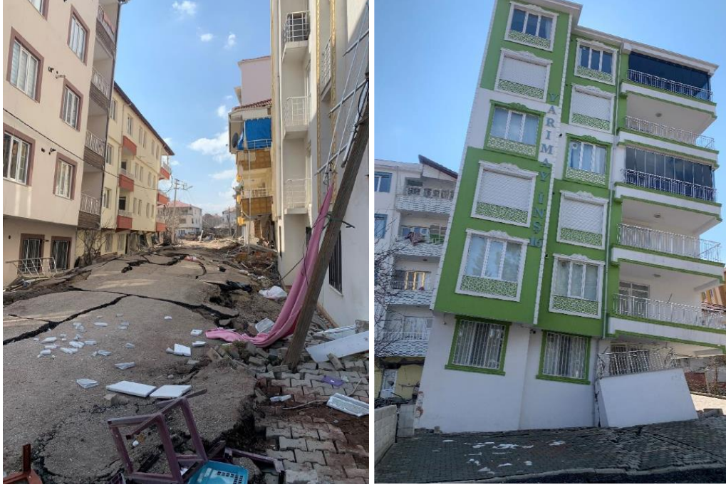
Resim 3.2. Çalışma alanında sıvılaşma kaynaklı zemin deformasyonları ve farklı oturmalar (G.Ü., 2023)
