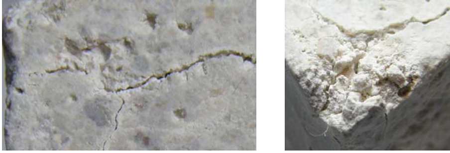
Resim 4.10. 360 gün yaşındaki PNB numunelerin yüzeyinde oluşan bozulmalar
