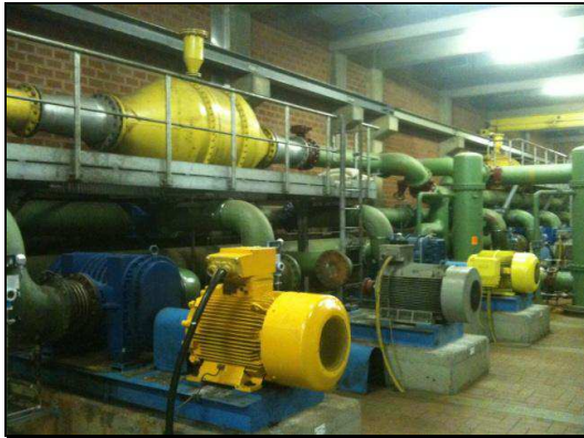
Resim 6.3. Gaz emme pompaları
