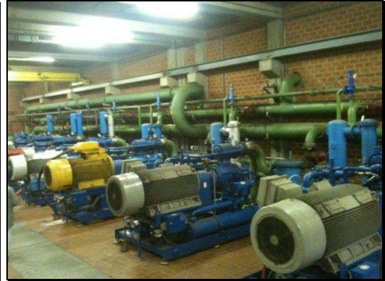
Resim 6.4. Gazın santrale pompalanması
