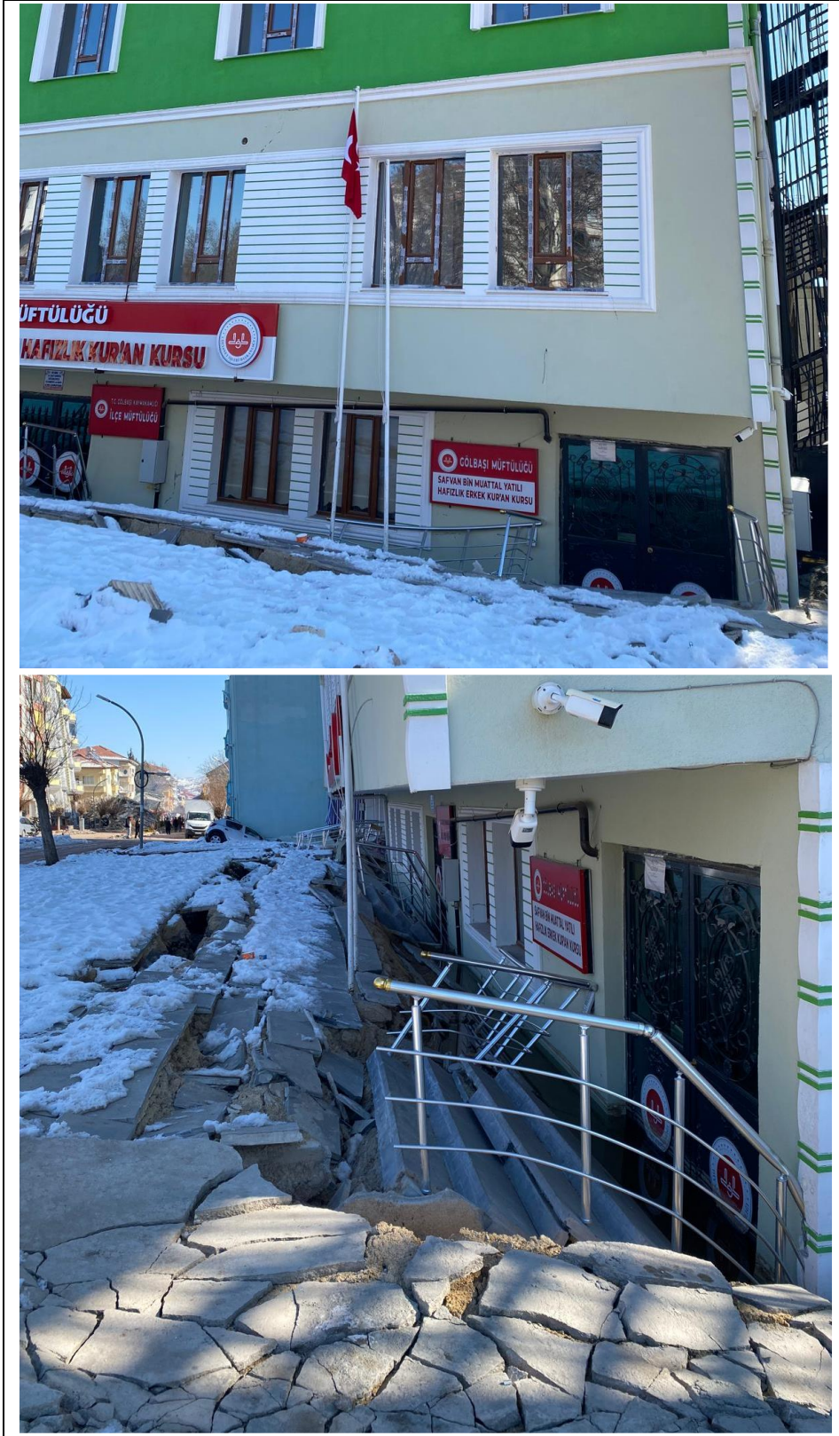
Şekil 4.5. Müftülük binasının deprem sonrası aldığı hasarı gösteren fotoğraflar
