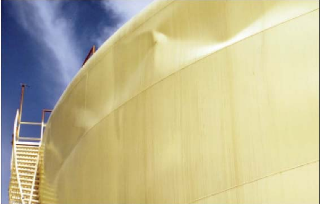
Resim 4.2.Tankın üst kısmında sıvı salınımından kaynaklanan hasar .
