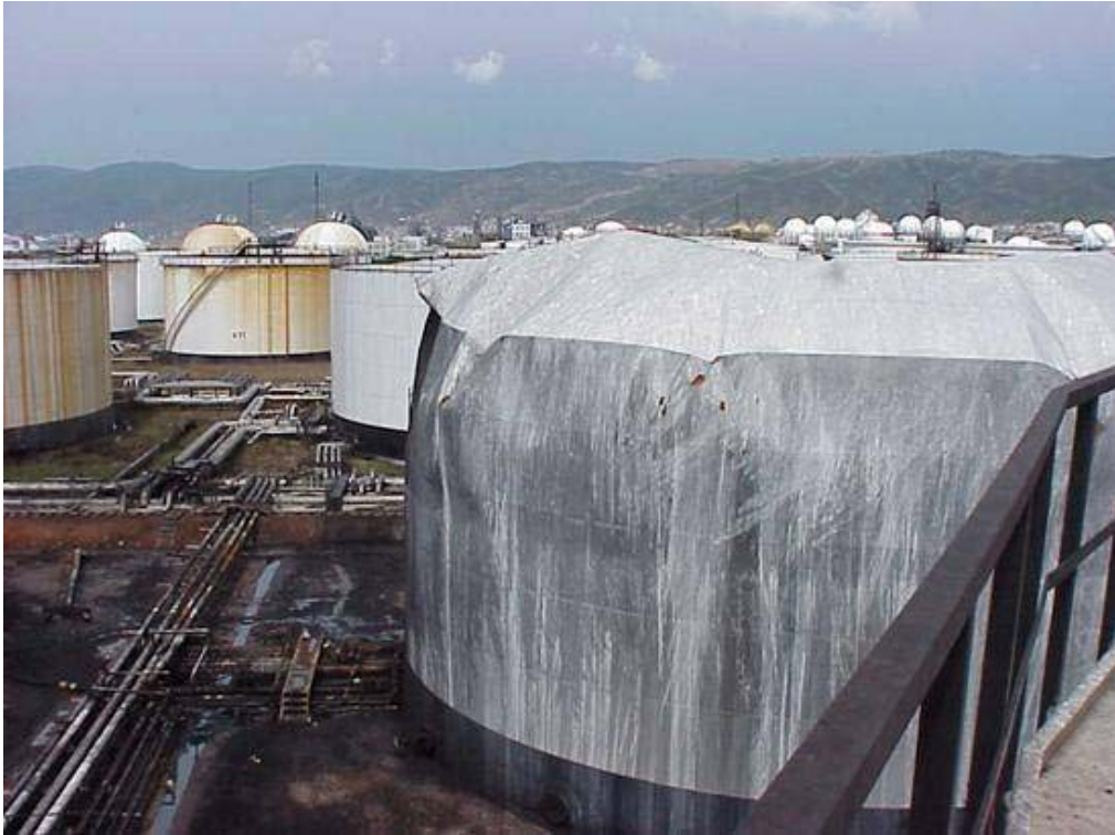
Resim 3.3.Deprem sonrası deforme olmuş tank.
