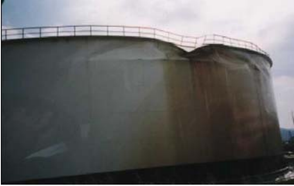
Resim 3.2.Tüpraş'ta deprem sonrası hasar görmüş nafta yakıt tankları
