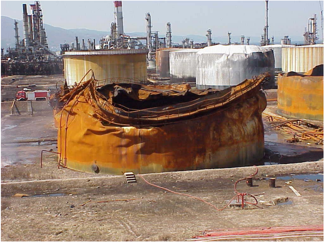
Resim 3.1.Tüpraş’ta deprem etkisiyle çıkan yangın nedeniyle hasar görmüş nafta yakıt tankları
