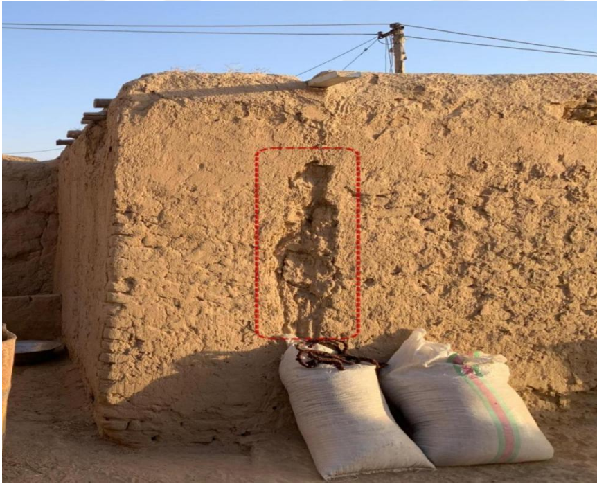
Resim 7.5. Yağmur suyunun etkisiyle tuğla duvarın üst kısmında oluşan karakteristik çatlak
