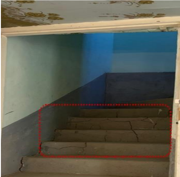
Resim 7.7. Çimento ve harçla kaplanmış, kerpiç merdivende hasar ve ayrılma çatlaklarının olduğu görülen
