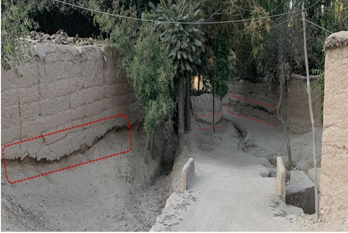
Resim 7.2. Suyun etkisiyle kerpiç duvarın tabanında oluşan dikey çatlaklar
