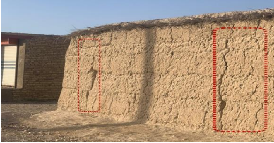
Resim 7.6. Kerpiç duvarda çeşitli dikey ve çapraz çatlaklar
