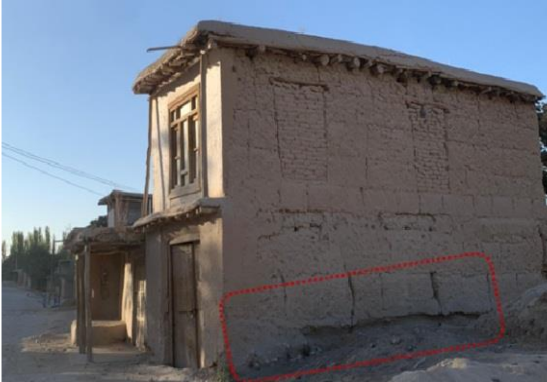
Resim 7.1. Kerpiç evin temelinin sudan dolayı hasar görmesi
