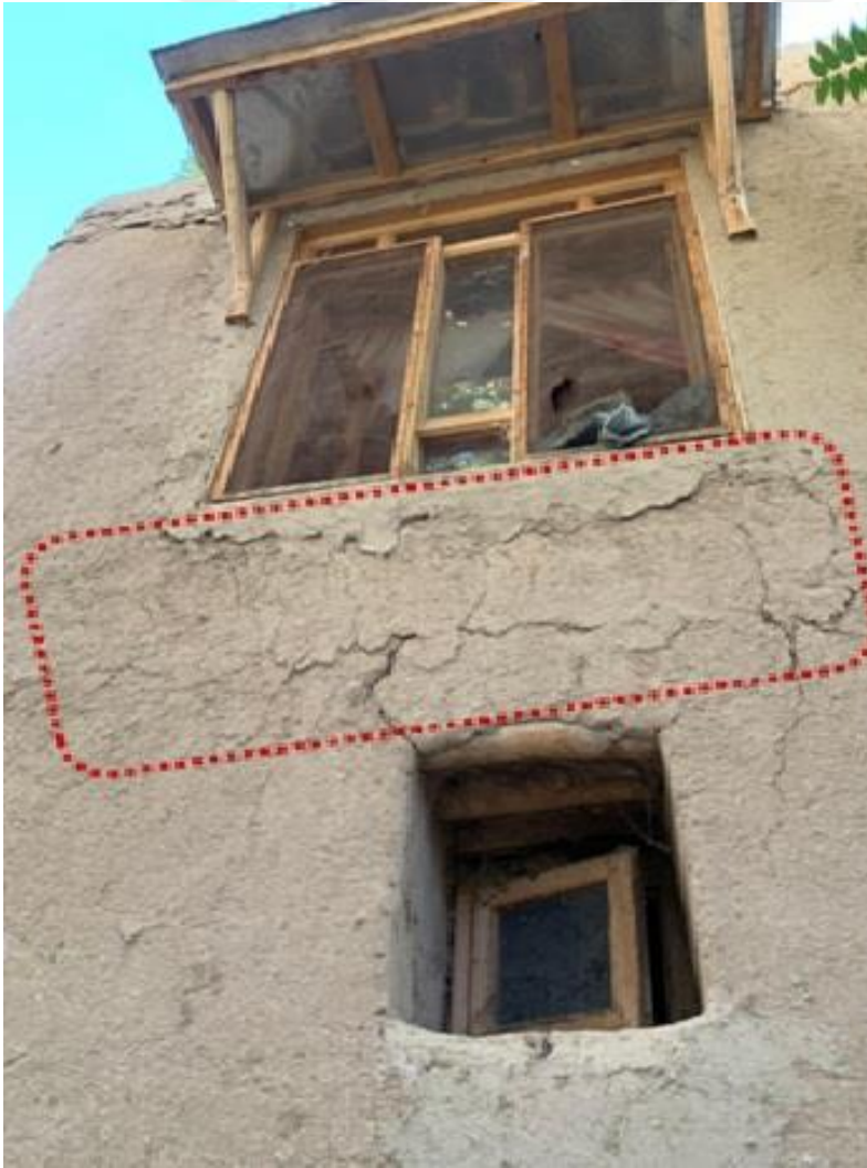
Resim 7.4. Bir binanın kerpiç cephesinde, üst kısımda aşınma, yıpranma ve ayrılma çatlakları gibi yapısal hasarlar görülmektedir
