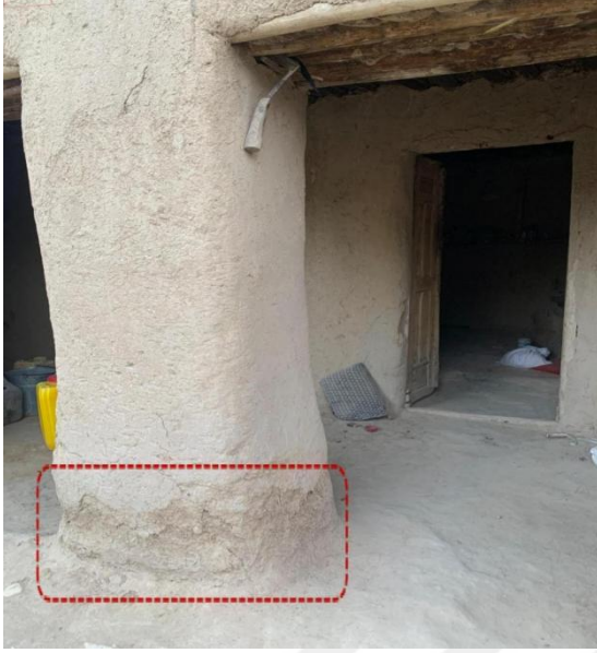
Resim 7.8. Kerpiç sütunun tabanındaki hasar
