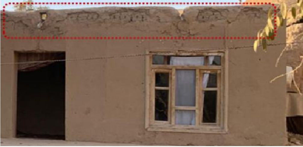
Resim 7.3. Cephe yüzeyinde hapsolan nem ve suyun yıkanması sonucu koruyucu kaplamanın kaybolması
