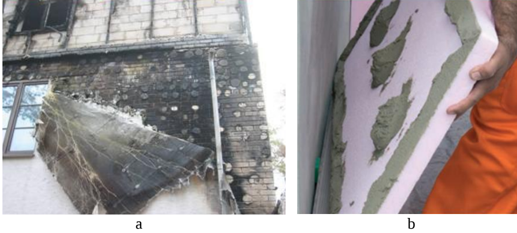
Resim 4.2. Mantolama sisteminde yapılan yapıştırma uygulamaları a. Hatalı uygulama b. Doğru uygulama [136]
