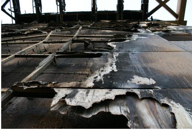
Resim 4.3. Alüminyum kompozit malzemelerin yangına tepkisi [139]
