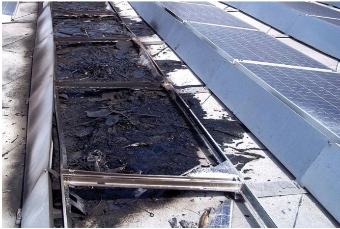
Resim 2.10. Fotovoltaik panellerin yangın sonrası durumu [81]
