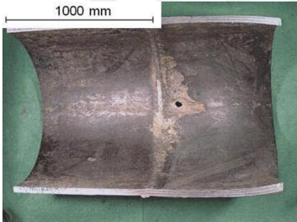
Resim 3.2. Petrol boru hatlarında iç korozyon [34]
