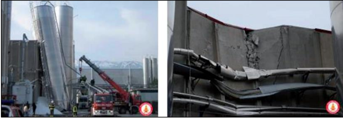
Resim 2.8. Bazzano-Paganica sanayi bölgesinde hasar gören silolar ve boru hattı (eNatech, 2022)
