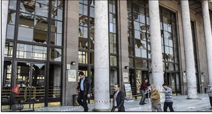
Resim 1.1. Ankara Tren Garı Saldırısında tarihi tren garında meydana gelen hasar (URL-24)
