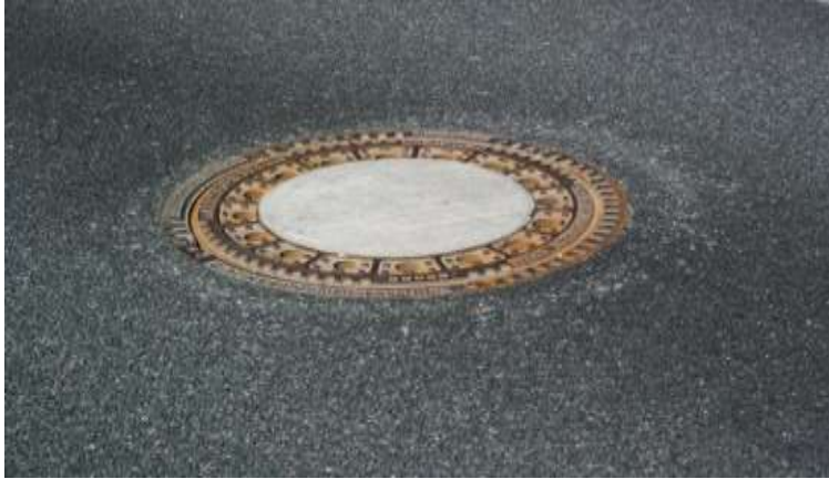
Şekil 3.5. Taşıt yolu ile aynı seviyede bir kanal kapağı [16]
