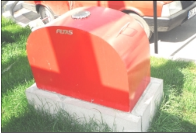
Resim 5.21. Armada alışveriş merkezi'nin çevresine yerleştirilen yangın dolapları
