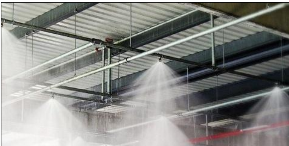
Image 3.5. Sprinkler system (URL-13)
