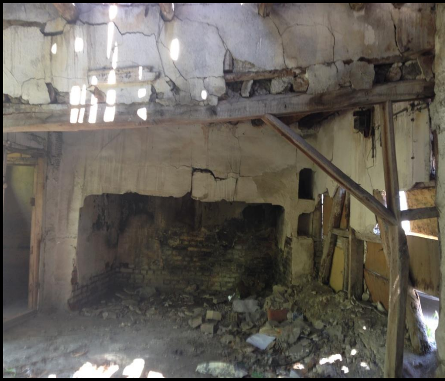
Resim 4.202. Tandır duvarındaki sehim, çatlak ve malzeme kaybı
