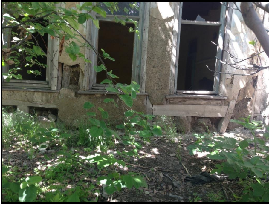
Resim 4.200. Bozulma, Z10 nolu oda pencereleri
