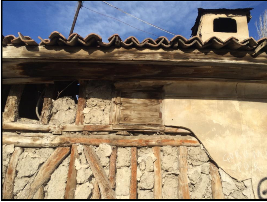
Resim 4.205. Bozulmalar, tandır yanındaki bahçe duvarı
