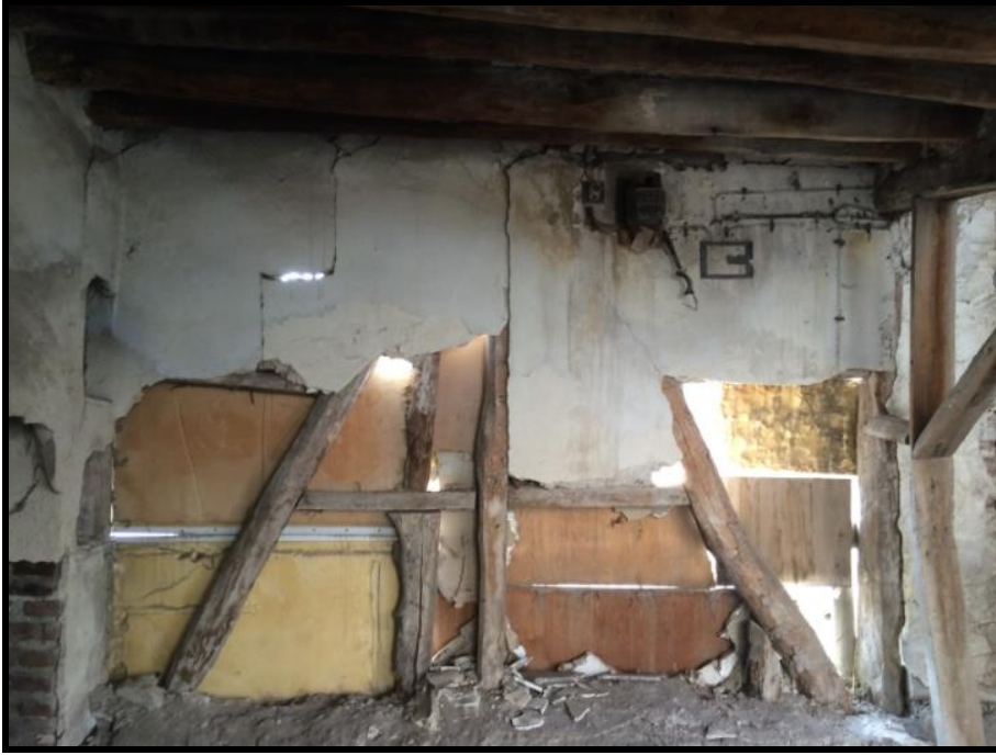
Resim 4.203. Sehim, çatlak ve malzeme kaybı, tandır yanındaki bahçe duvarı
