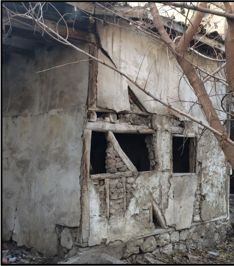
Resim 4.204. Malzeme kaybı ve sehim, haymalık duvarı
