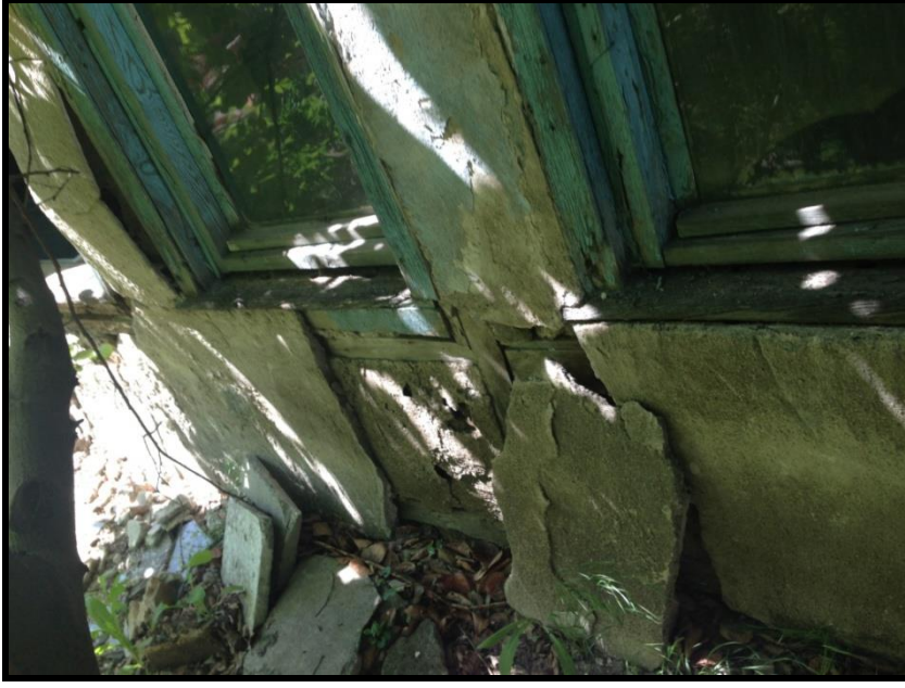
Resim 4.199. Bozulma, Z01 nolu oda pencereleri
