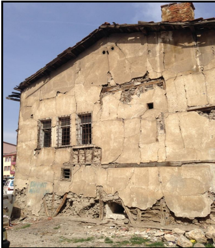
Resim 4.198. Malzeme kaybı, batı cephesi
