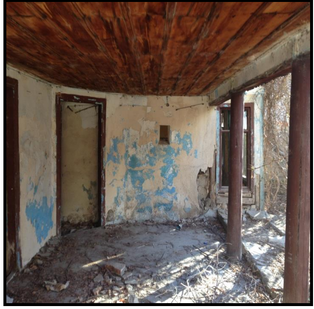
Resim 4.210. Boya dökülmesi, Z11 duvarları
