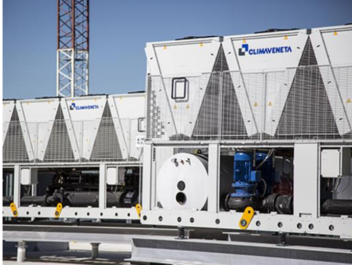
Resim 4.61. Adigeo avm'nin çatısında bulunan HVAC sistemi [78]
