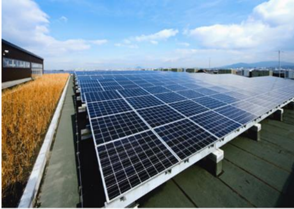
Resim 4.42. Aeon avm çatı güneş panelleri [66]
