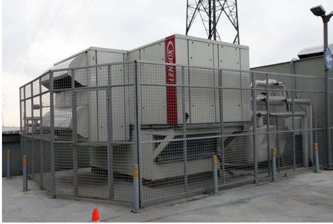
Resim 4.9. Torium avm çatı tipi klima ünitesi [41]
